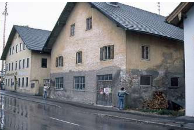
Aus diesen maroden Gebäuden – links der ehemalige Gasthof »Zur Post« – ...
