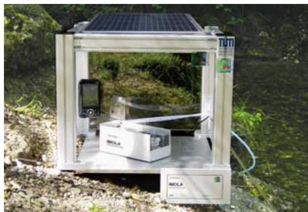
Solarzellen versorgen das Wasserüberwachungsgerät mit Energie, die Daten werden per Mobiltelefon übermittelt
