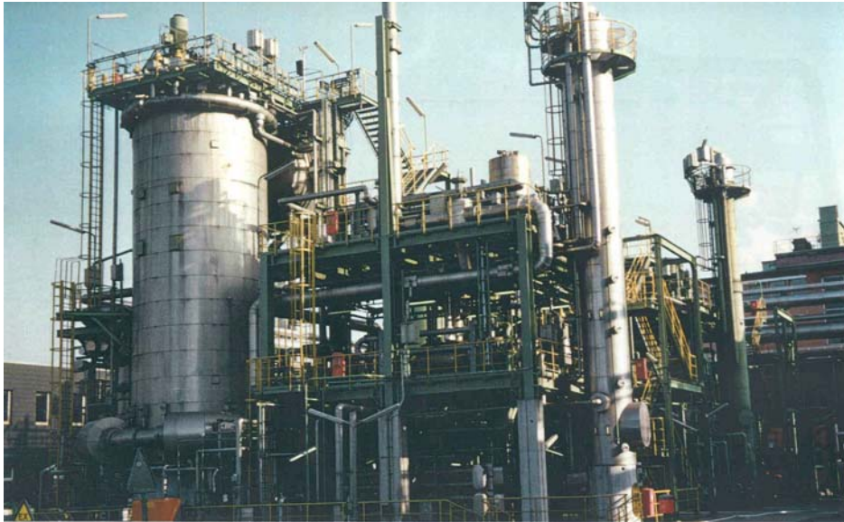
Die erste Produktionsanlage für Butyraldehyd nach dem Ruhrchemie/Rhône-Poulenc-Verfahren (1984)
